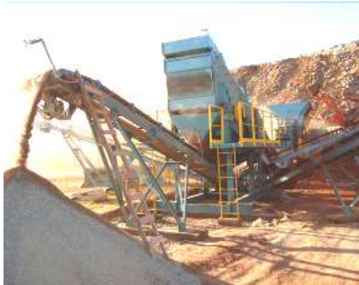
Foto 8.1.3.3-1 Vista da Usina de RCC da Morada Ambiental
