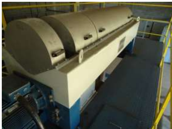
Foto 6.3.2.2-2 Sistema de Desaguamento e Secagem Térmica do Lodo
