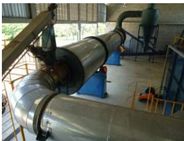
Foto 6.3.2.2-4 Sistema de Desaguamento e Secagem Térmica do Lodo
