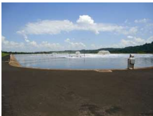
Foto 6.3.2.2-1 Lagoa Aerada com Aeradores do Tipo Submerso Propulsor
