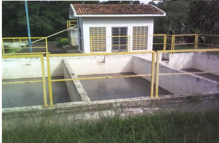
Estação de Tratamento de Esgoto
